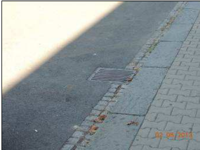
Fotografie č. 1 - Vpusti vhodné pro provoz cyklistů na vozovce (Ostrava)
